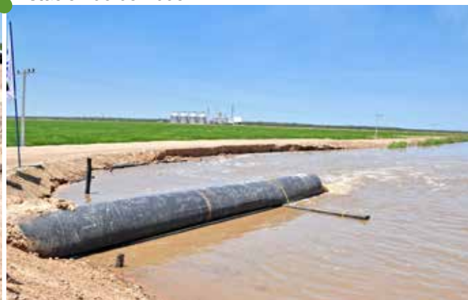
Estación de bombeo.
